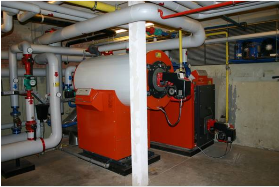
Zicht op de gasketels in de stookplaats
